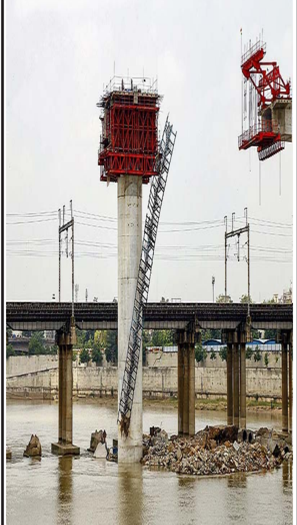
गुजरात के अहमदाबाद में हाल ही में आई बाढ़ के कारण साबरमती नदी पर अहमदाबाद-मुंबई बुलेट ट्रेन परियोजना का क्षतिग्रस्त ढांचा, जिससे काम रुक गया है।
